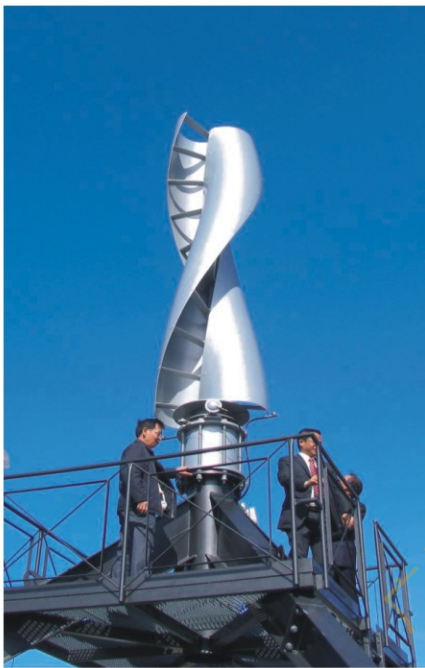
风力发电机外观实景
