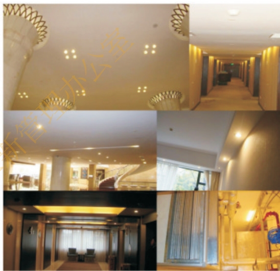
图2-5 改造后大楼照明实拍图
