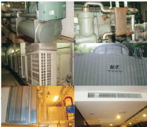
图2-4改造后空调系统主要设备实拍图
