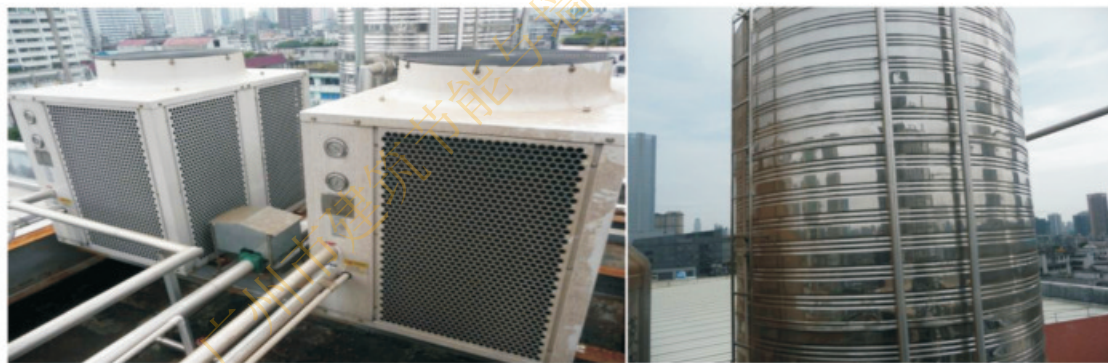
图4-7 空气源热泵及不锈钢保温水箱实拍图
