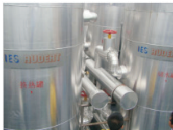
图6-3蓄热系统实拍图
