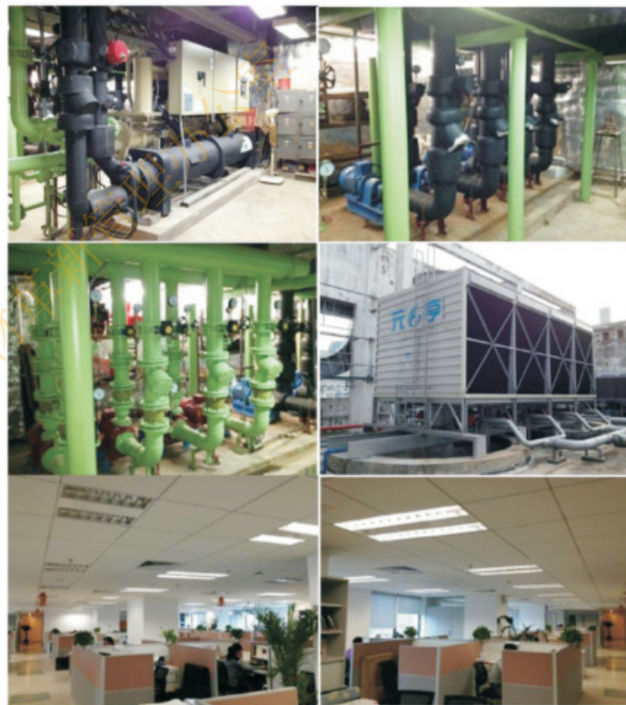
图1-4 改造后空调系统设备实拍图
