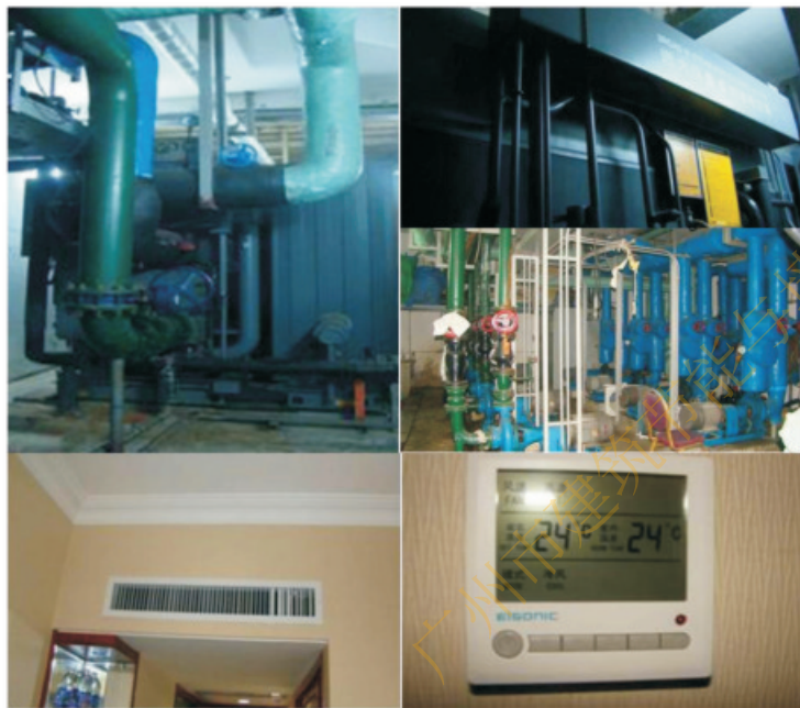
图5-2 改造后空调系统实拍图
