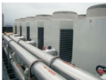
图6-2涡旋热泵机组实拍图
