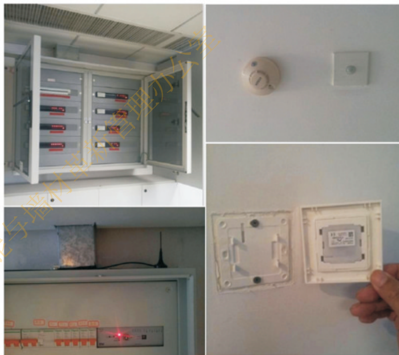
图1-6 智能照明控制系统实拍图
