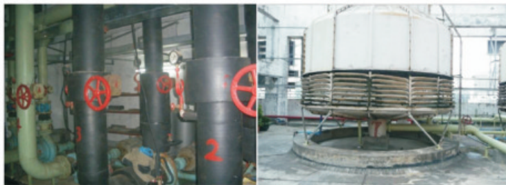
图1-2 改造前水泵、冷却塔现场实拍图
