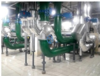
图2 精密空调机房实景图
