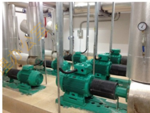
图8 冷冻水泵实拍
