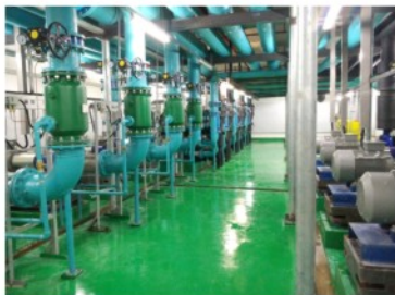
图9 空调制冷机房实景图
