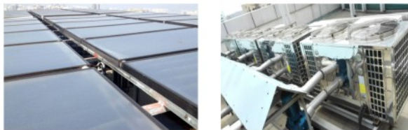
图7 太阳能集热板和辅助热源(空气源热泵)
