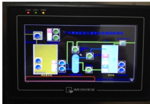
图9 雨水系统显示面板
