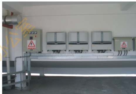
光伏系统逆变设备安装实景图
