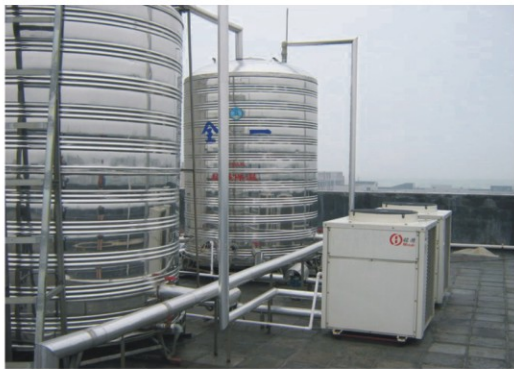
空气源热泵热水系统
