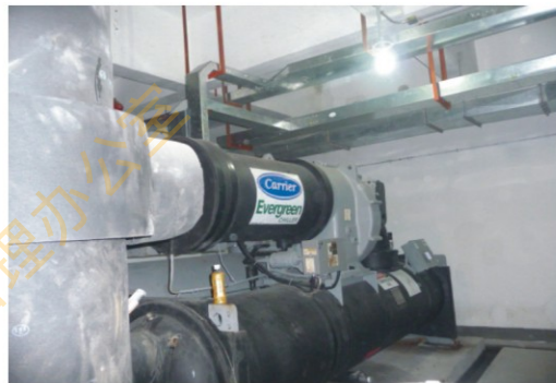
中央空调机房
