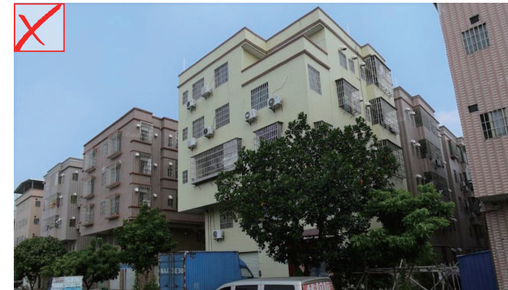
空调外机直接裸露，各个面均有空调外机，高度等均不统一
