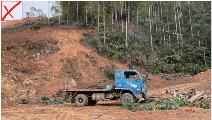
违规削坡建房对后山山体结构造成破坏
