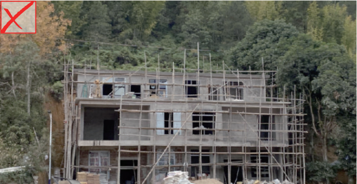
违规削坡建房对后山山体结构造成破坏
