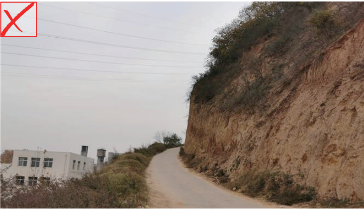
道路两侧山体大面积露土，道路扬尘严重且易造成山体滑坡
