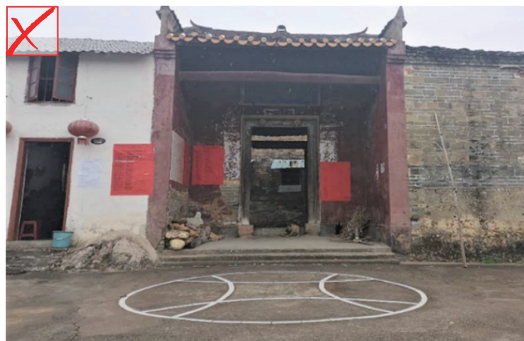
传统风貌建筑前庭改造时，用水泥铺装覆盖原有鹅卵石地面，破坏了传统风貌
