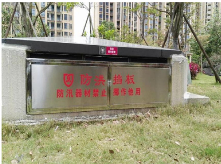
地下室的地面通风口、通风井设置防洪挡板
