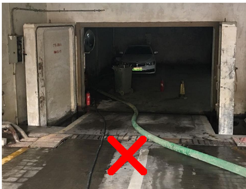
人防门关闭范围被混凝土阻挡，无法关闭
