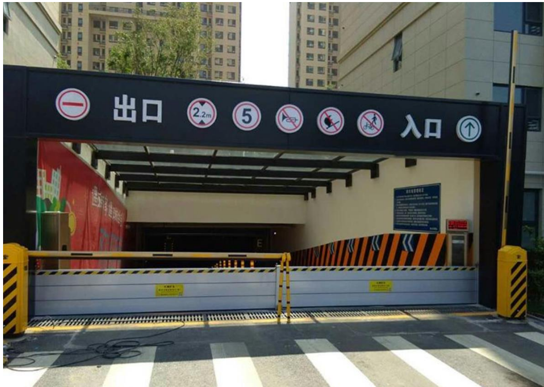
防洪闸门（多段组合式）
