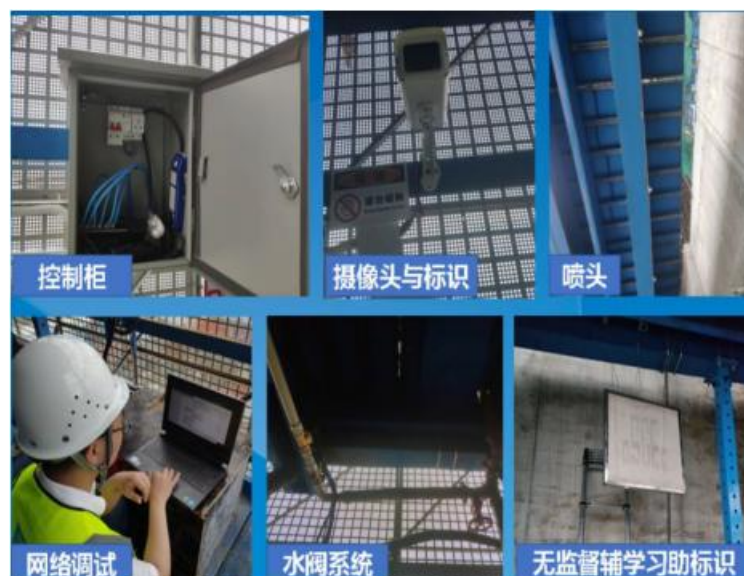
混凝土 AI 养护系统
