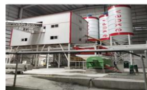
污水处理系统
