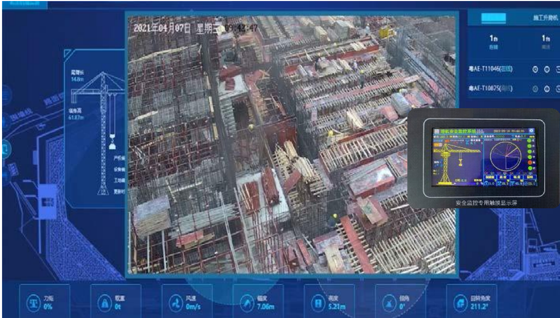
塔机安全监控
